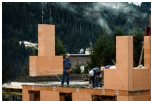
Hier kommt die Wand. Die Ziegel-Wandelemente werden einfach mit einem Kran ins Mörtelbett versetzt, anschließend mit Schrägstützen fixiert und die Stoßfugen mit Mörtel verschlossen. Bild: tdx/Hörl+Hartmann/Roland von Kummant
