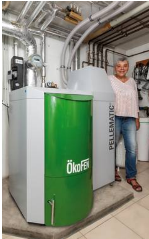
Nach 30 Jahren ließ Anita Kempf ihre alte Heizung austauschen. Sie nutzte die Chance zum Brennstoffwechsel und entschied sich für eine umweltfreundliche und energieeffiziente Pelletheizung von ÖkoFEN. Bild: tdx/ÖkoFEN
