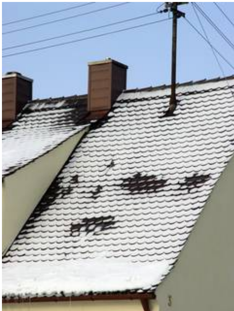
Dämmlecks werden bei Schnee auf dem Dach deutlich sichtbar. Bild: tdx/homesolute.com
