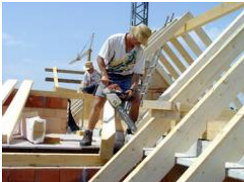
Eigenleistungen können die Investition in ein Eigenheim spürbar reduzieren. Allerdings sollten Dachdecker- und Zimmererarbeiten noch immer dem Fachmann überlassen werden. Bild: tdx/RGBuW
