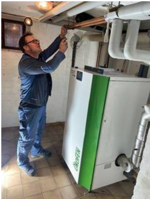
Die SHK-Betriebe sind auch aktuell für ihre Kunden im Einsatz. Im Keller arbeitet der Heizungsfachmann – hier Anlagenmechaniker Mirko Niemann aus Bad Oeynhausen – alleine, deshalb besteht bei Einbau der neuen Heizung keine Infektionsgefahr. Bild: tdx/ÖkoFEN
