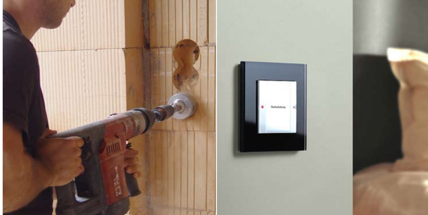
BU: Bereits in der Rohbauphase werden die Weichen gestellt für die künftige Elektroinstallation. Darum ist eine sorgfältige Planung besonders wichtig. Bild: tdx/homesolute.com
